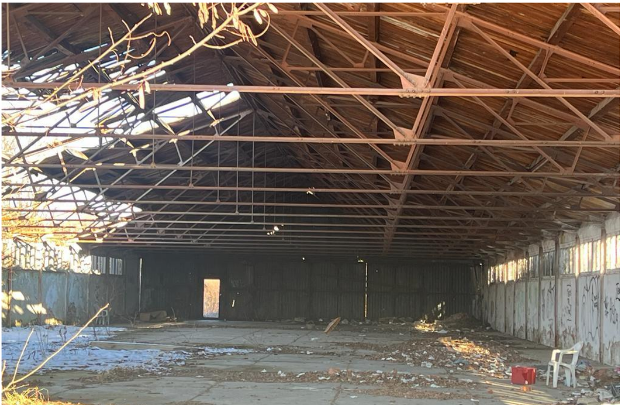
Slika 4.: Prikaz lošeg stanja građevine.
