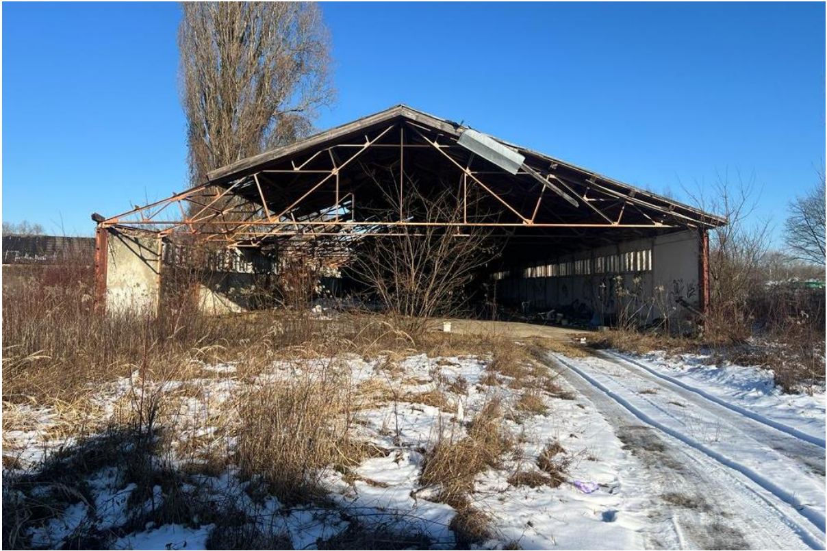
Slika 3.: Prikaz lošeg stanja građevine.
