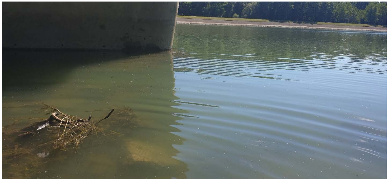
Slika 5. Noseći stup mosta i nakupine mrtvih grana i vegetacije koje se zadržavaju oko Mosta hrvatskog bana Josipa Jelačića, transekt 2
