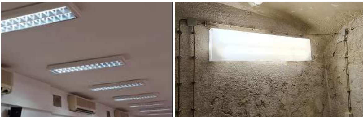
Slika 1 – Postojeća rasvjetna tijela sa T8 fluo cijevima
