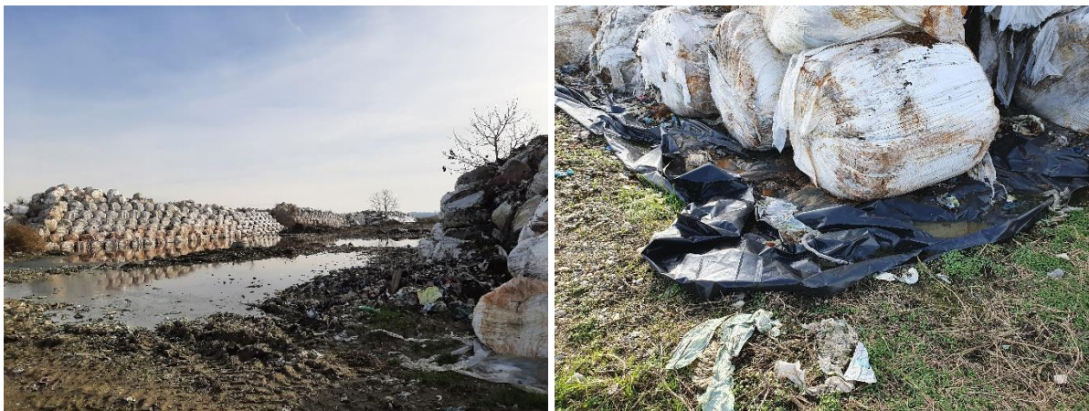
Slika 34. Pogled na formirani koridor servisne ceste i premještene bale na vodonepropusnoj foliji (izvor: Ecomission d.o.o., slikano 19.11.2021. godine)
